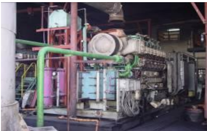
Générateur d'électricité à BRANA
