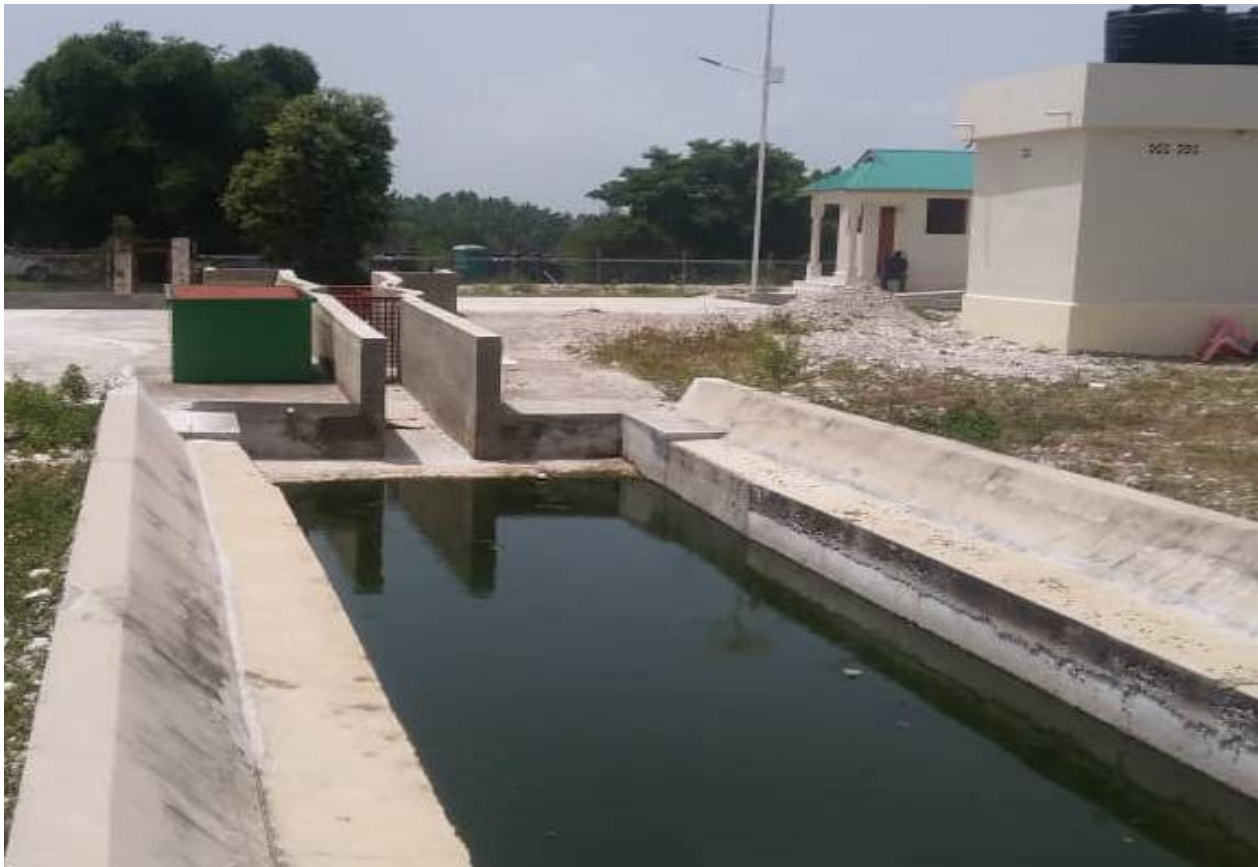
FIGURE 8 : IMAGE DU DECANTEUR INITIAL
