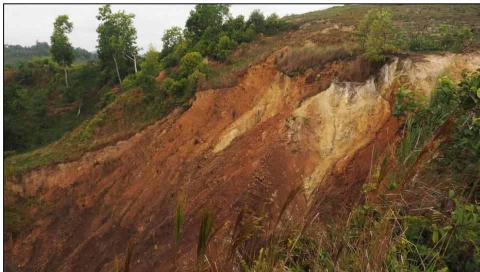
FIGURE 90 : GLISSEMENT DE TERRAIN DANS LE COMPLEXE DE BARADÈRES-CAYEMITES.
