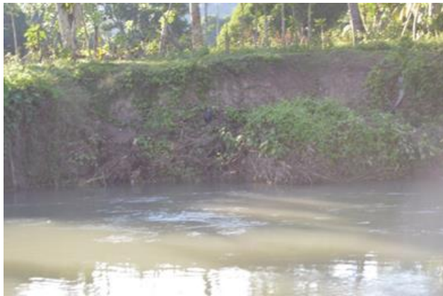
FIGURE 56 : EFFONDREMENT DES BERGES À LA STATION BD3
