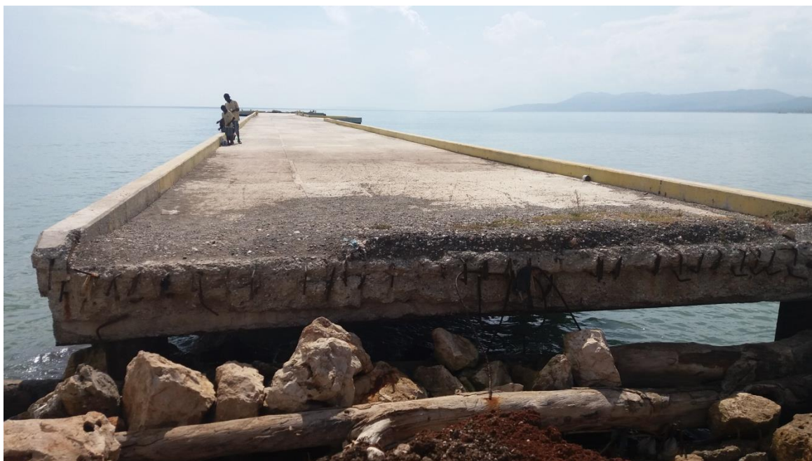
Détérioration du nouveau wharf de Jérémie
