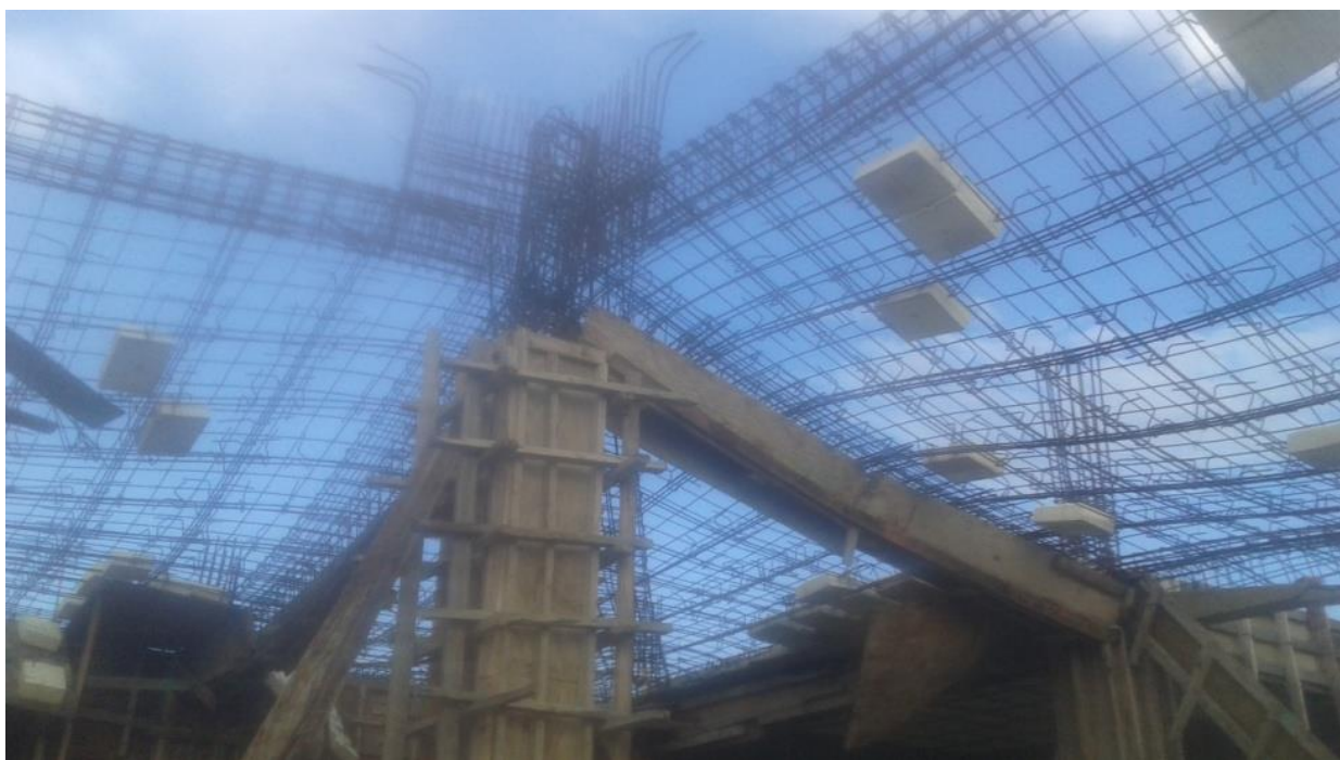
Etat de la toiture du marché de Fontamara
