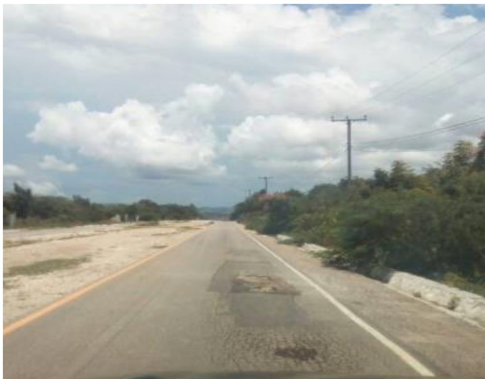
Route Carrefour 44/Cotes-de-Fer en dégradation
