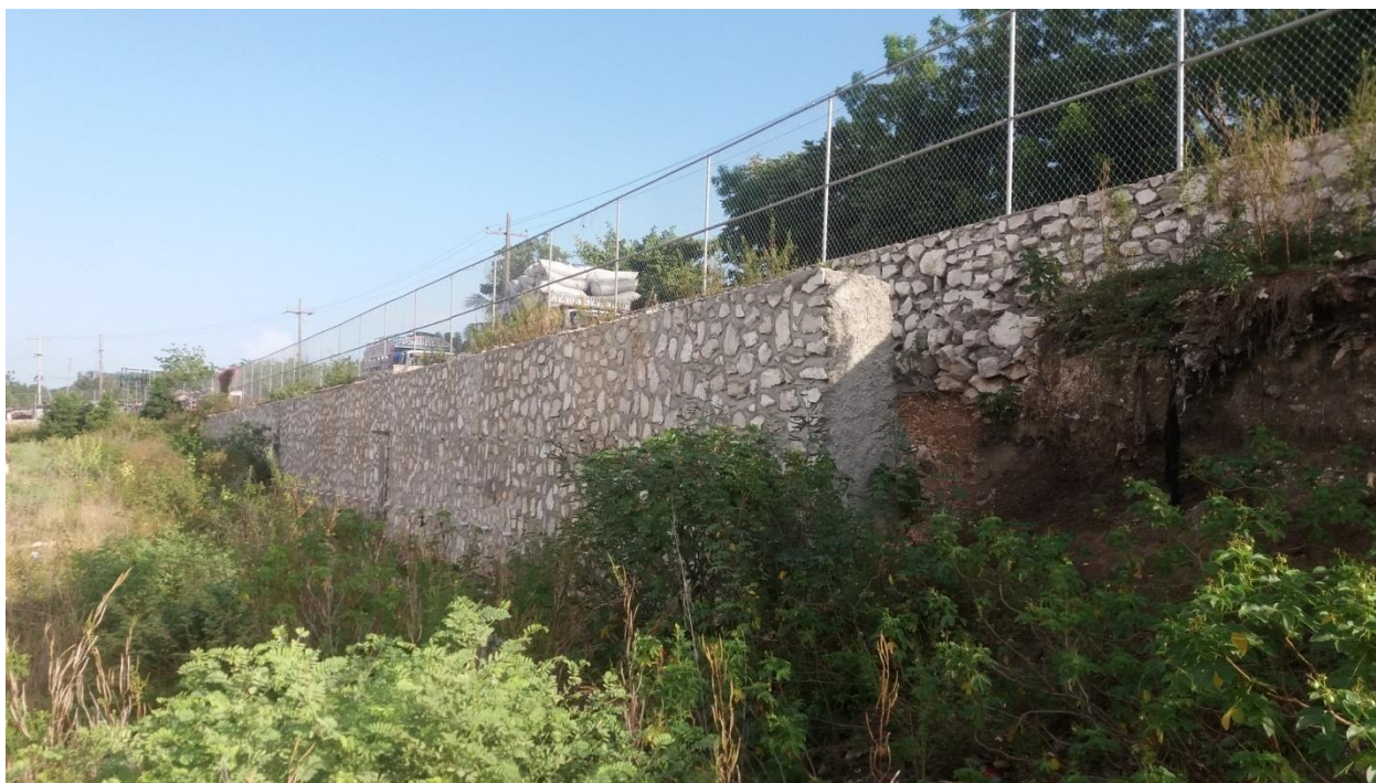
Mur de soutènement inachevé
