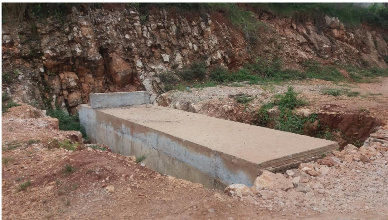
Travaux de drainage inachevé
