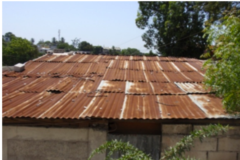
Dessin 88 : Toiture existante fixée par des clous
