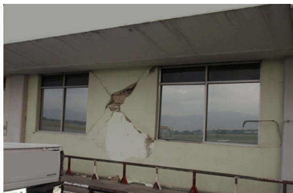
Dessin 7 : Rupture en croix d'un contreventement
