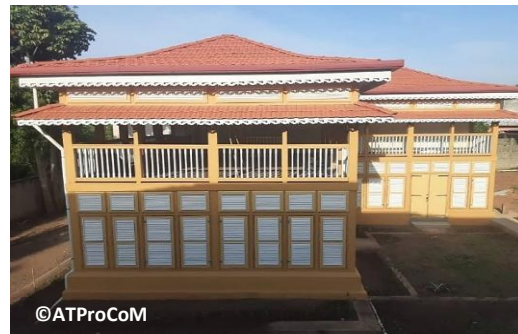
Couverture en tuiles de terre cuite
