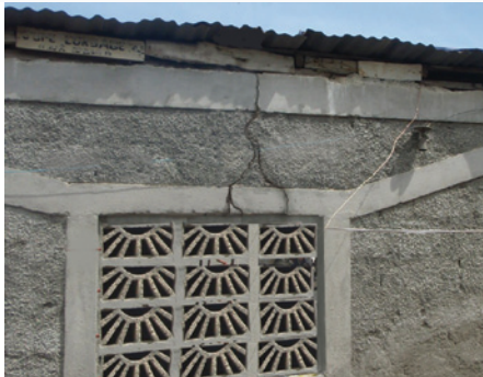
Description – Fissure au linteau au dessus d'une fenêtre
