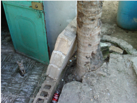
Description – Mur incliné ou partiellement effondré.
