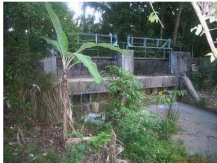
Point 86 : Vannes de transfert des eaux
