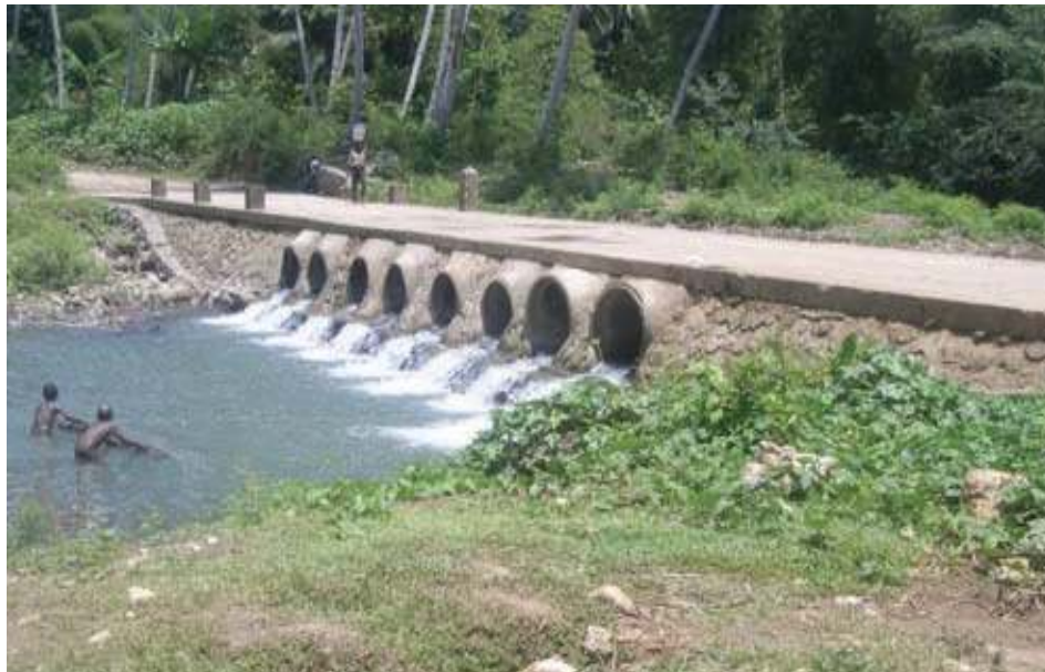
Photographie: Exemple de ponceau à huit buses
