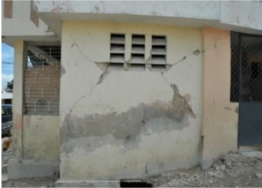
Figure B2. Exemple de fissure en X
