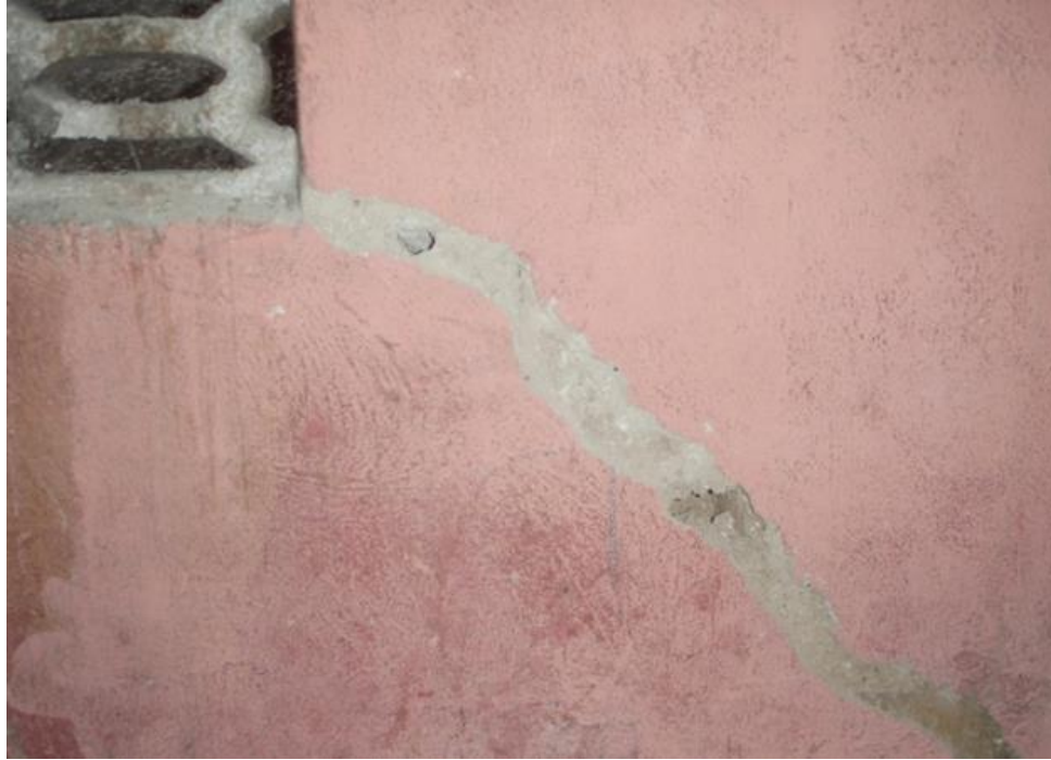
Figure F1. Exemple de fissure mineure
