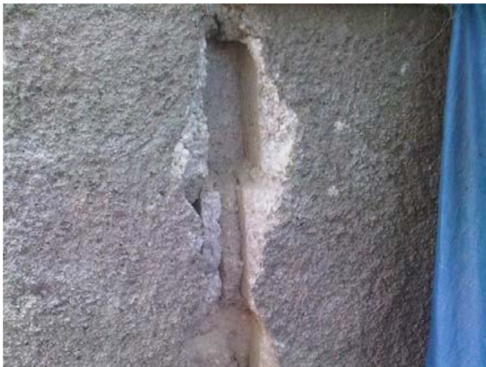
Figure F2. Exemple de fissure modérée
