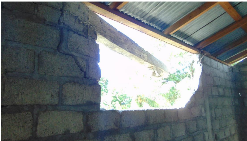
Figure D1. Exemple d'un linteau endommagé
