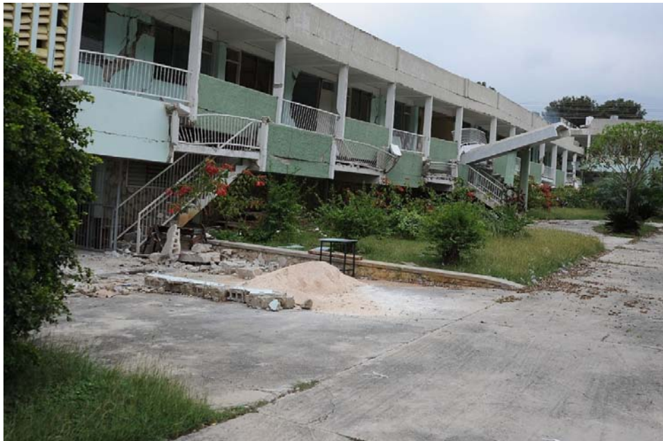
Figure 6. Effondrement du rez-de-chaussée de la résidence des frères de l'Institution Saint-Louis de Gonzague à Delmas 31-33.
