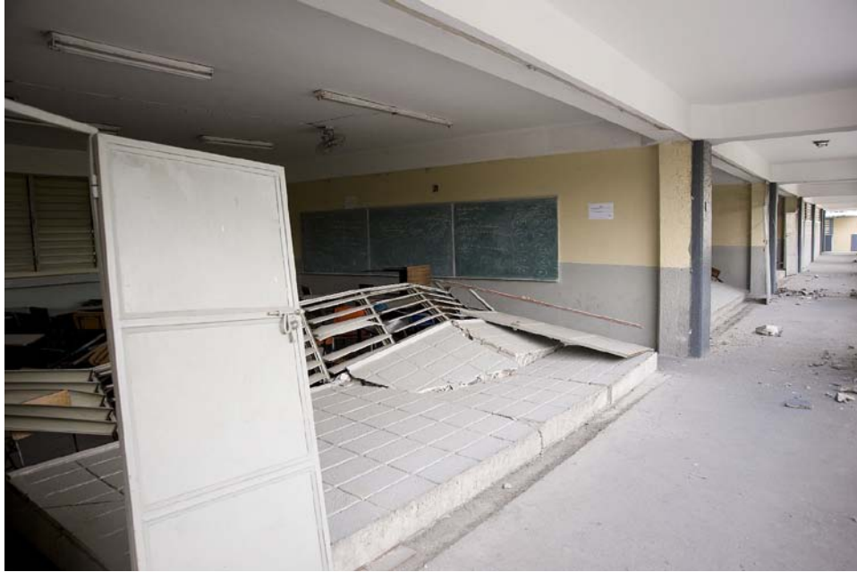
Figure 5. Renversement des murs en parpaing creux par manque de support latéral à l'École de formation professionnelle Canado-Haïtien. La même situation s'est reproduite à l'Institution Saint-Louis de Gonzague à Delmas.
