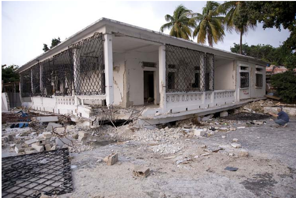
Figure 4. Effondrement de l'École hôtelière par écrasement du rez-de-chaussée : étage flexible et faible.
