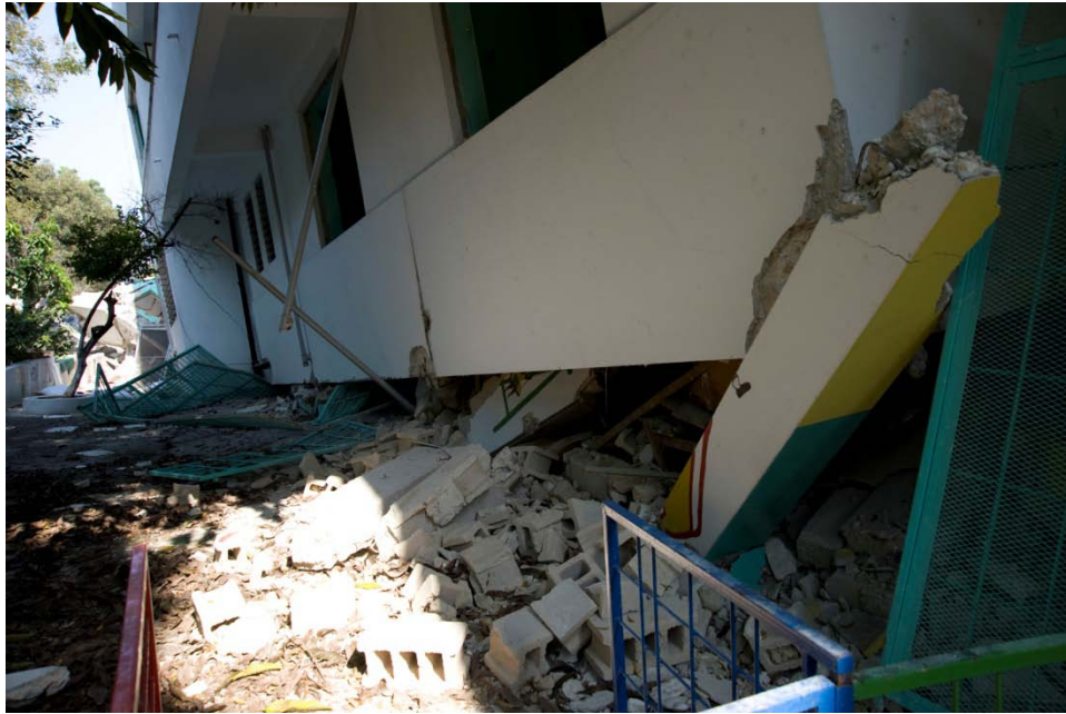
Figure 8. Effondrement du rez-de-chaussée de la maternelle du Juvénat à Pétion-Ville : étage flexible et faible, terrain en pente.
