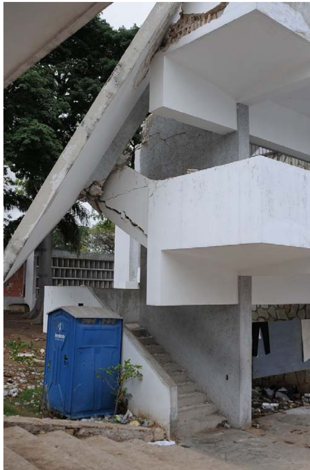
Figure 7. Effondrement du toit de protection de l'escalier menant aux classes de la 3 e à la terminale (2 e cycle) de l'Institution Saint-Louis de Gonzague (un des deux escaliers de secours en cas d'urgence) à Delmas 31-33.
