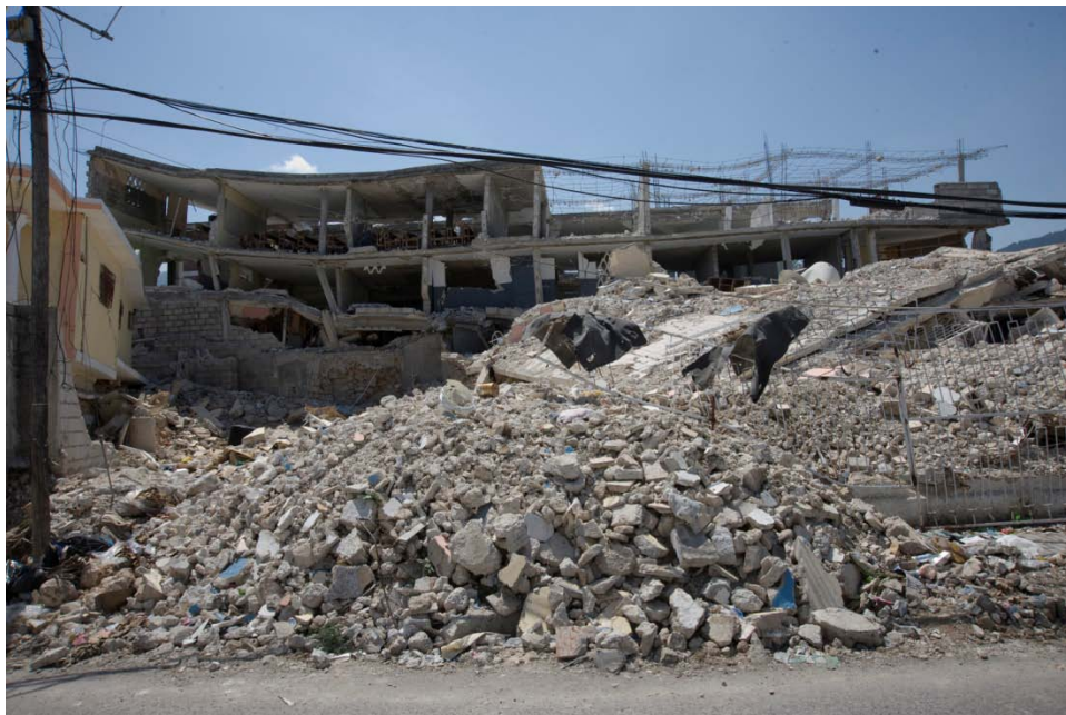
Figure 9. Effondrement d'une école à Delmas 83 : manque d'un système de résistance aux forces sismiques.
