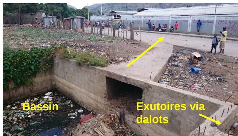
Figure 10 : Bassin récupérant les eaux de la ravine Colezong (Marché en arrière-plan)
