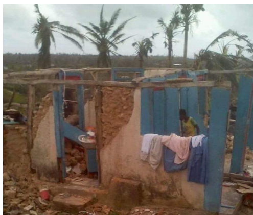
Image 1 : Vue d'une maison totalement endommager
