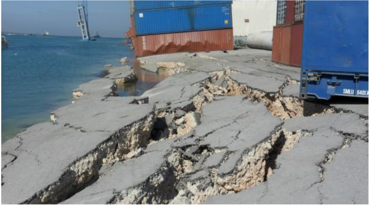
Figure 3 : Déplacements latéraux liés à la liquéfaction du sol dans la zone portuaire de Port-au-Prince lors du séisme du 12 janvier 2010 (source : Rathje et al., 2010)
