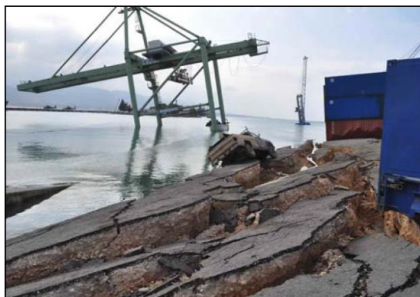
Figure 24 : Effet de la liquéfaction – Glissement latéral observé sur le port de Port-au-Prince (Haïti) suite au séisme du 12/01/2010
