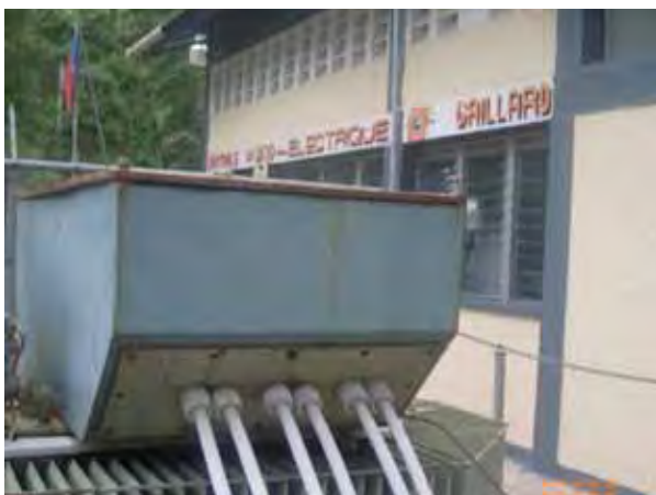
Centrale hydro-électrique Gaillard à Cayes Jacmel
