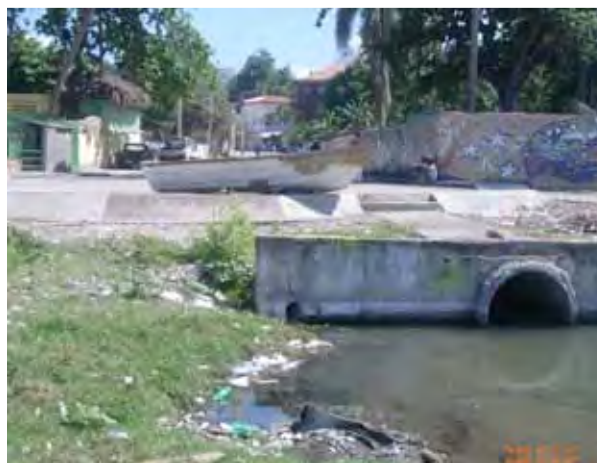
Émissaire du bassin la Liberté (diamètre de 1 mètre)
