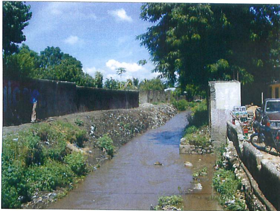
Photo 10: Réseau de drainage à réhabiliter
