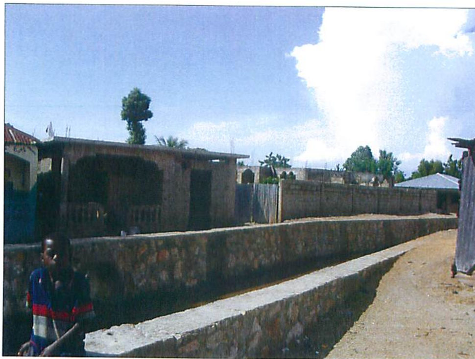
Photo 11: Réseau de drainage à réhabiliter
