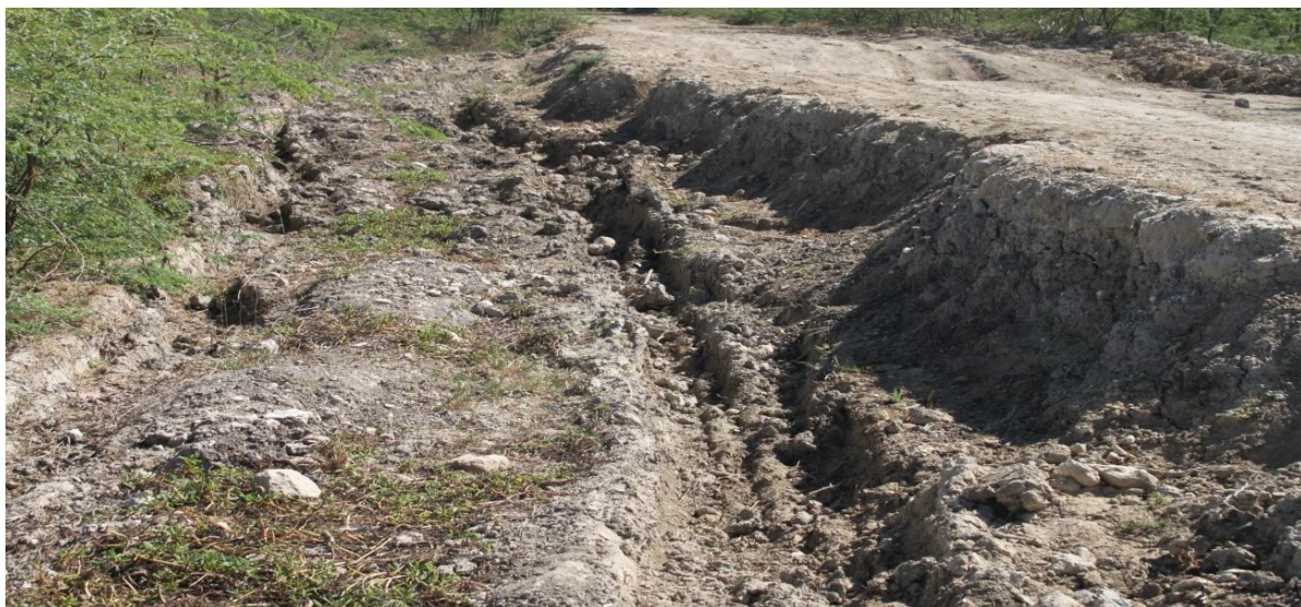
Photo 1: Vue partielle de l'état de la route de Port-de-Paix - Jean Rabel
