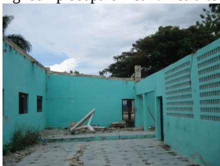
Eglise Episcopale Acul : Détruite
