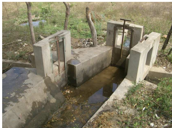
Image n°24: Écluses de système d'irrigation
