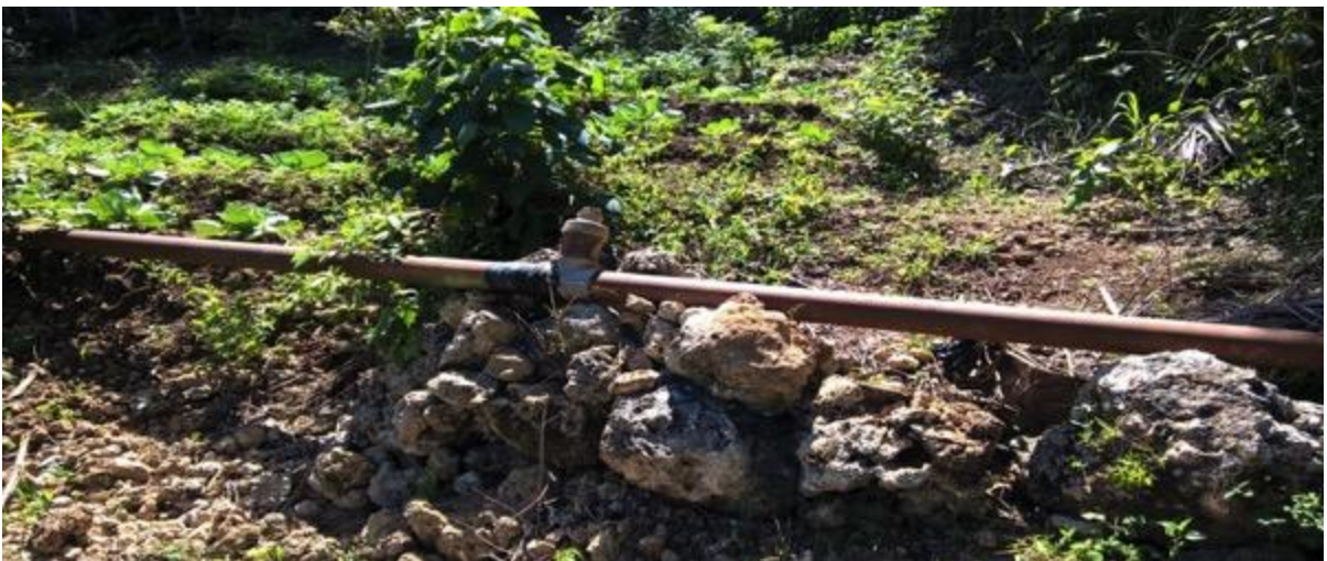
Fig6. Vue du tuyau exposé à l'air libre
