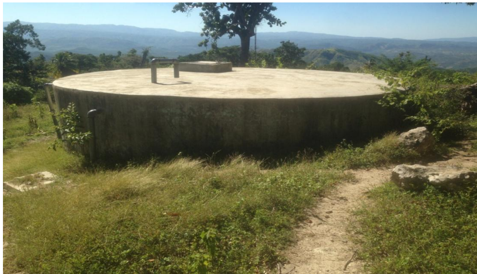
Réservoir de stockage semi enterré de Marc Fontaine
