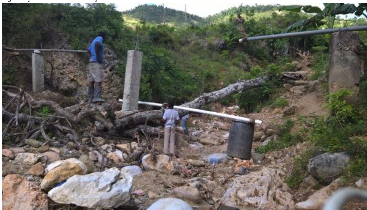
Fig9. Tuyau exposé durant la traversée de la ravine.
