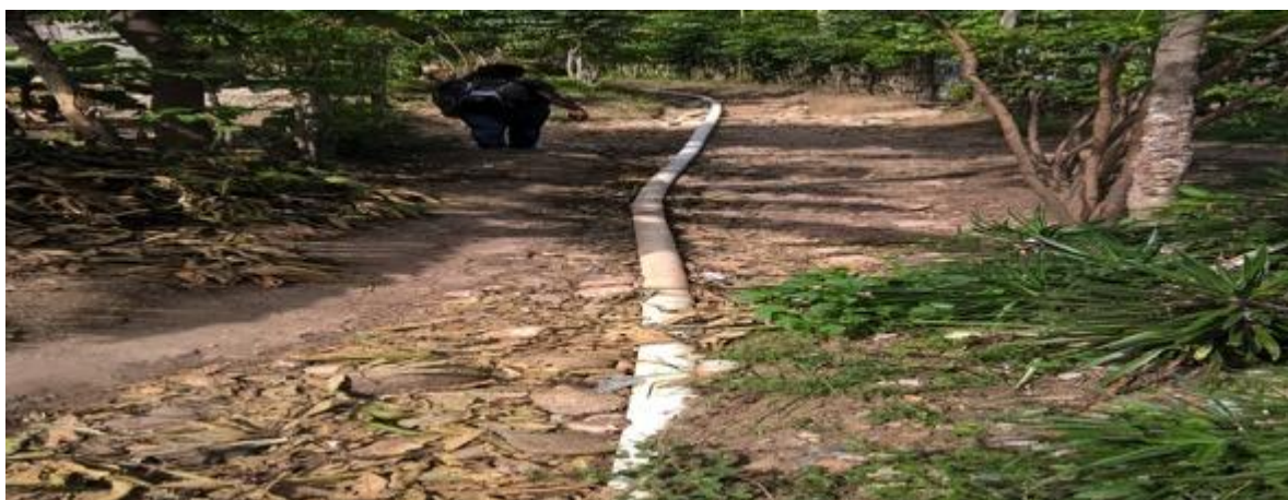
Fig7. Tuyaux exposés a cause de l'érosion du sol.
