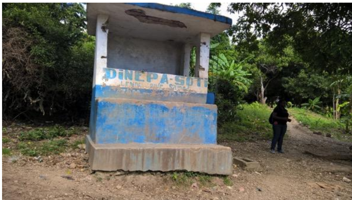
Fig10. Vue d'un kiosque du réseau de Mapou.
