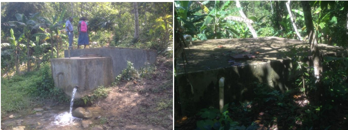
Réservoirs sur le réseau de Guichard
