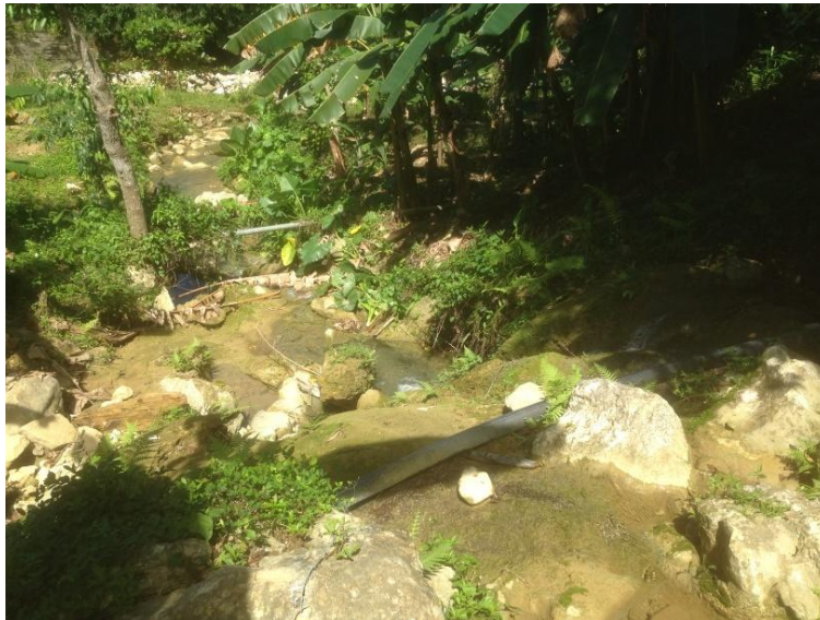
Conduites non protégées
