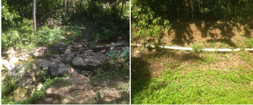
Conduites sans aucune protection
