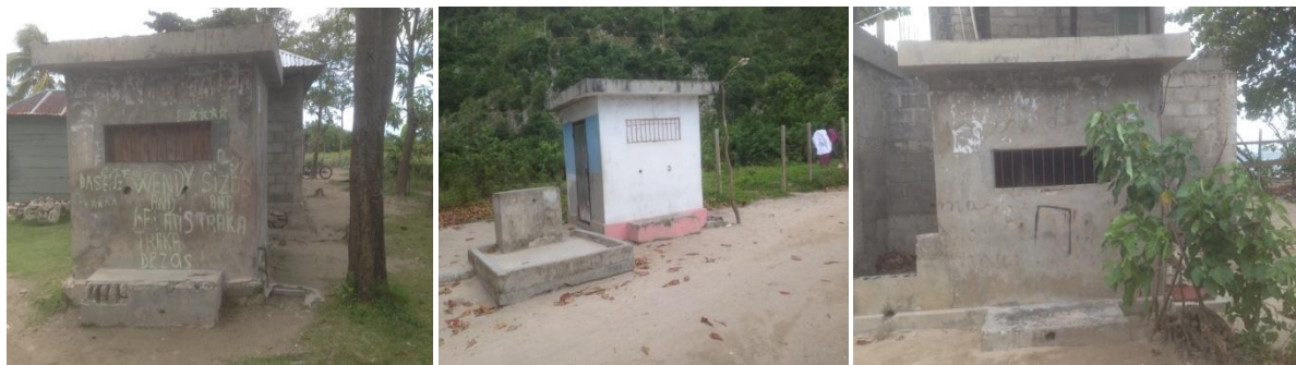
kiosques hors service sur le réseau de Dubois
