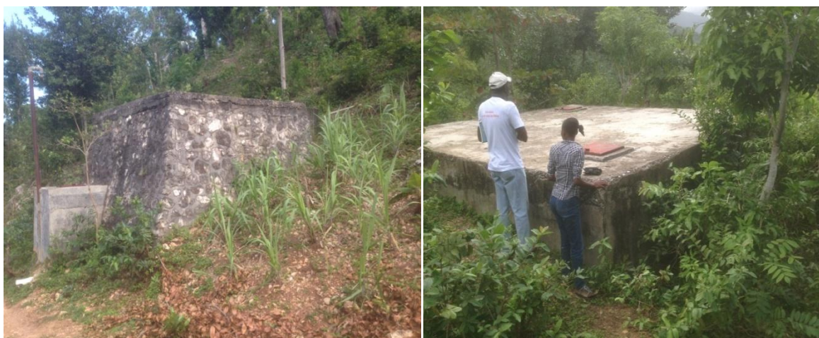
Réservoirs semi enterrés et non protégés
