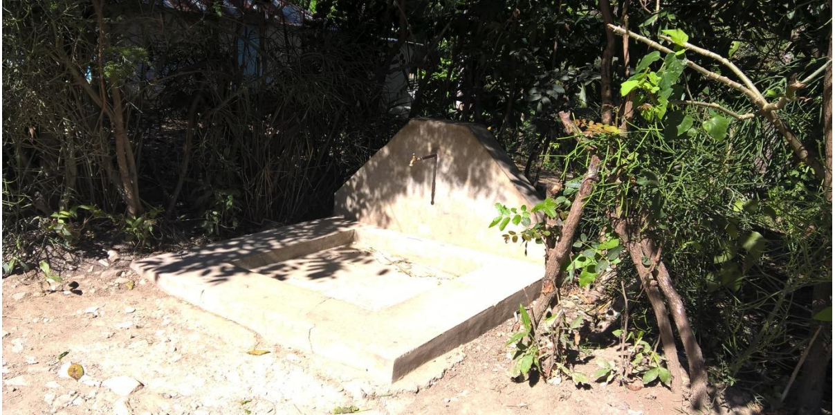
Fig. 4. Borne-fontaine sur le réseau de Dige
