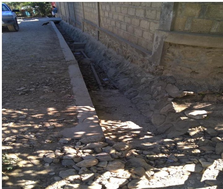
Fig 3. Conduite exposée a l'air libre
