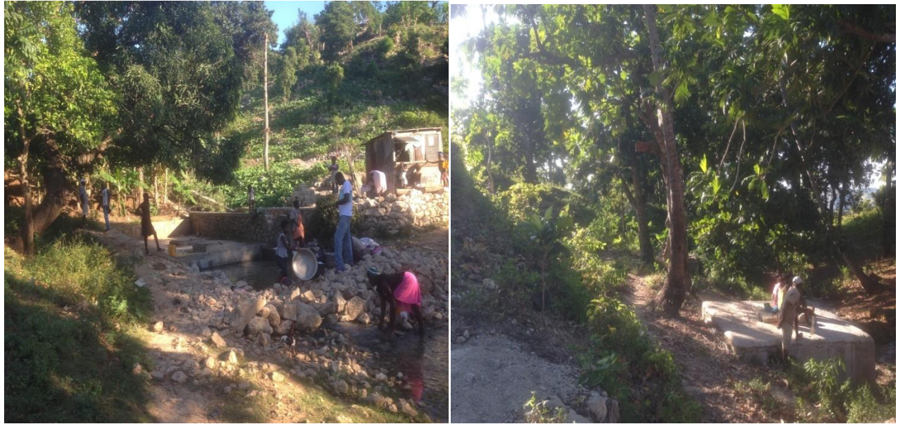
captage source Beauvoir et bassin collecteur
