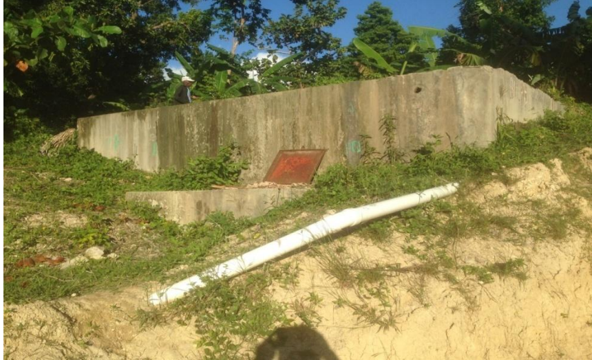
Réservoir et conduite non protégée
