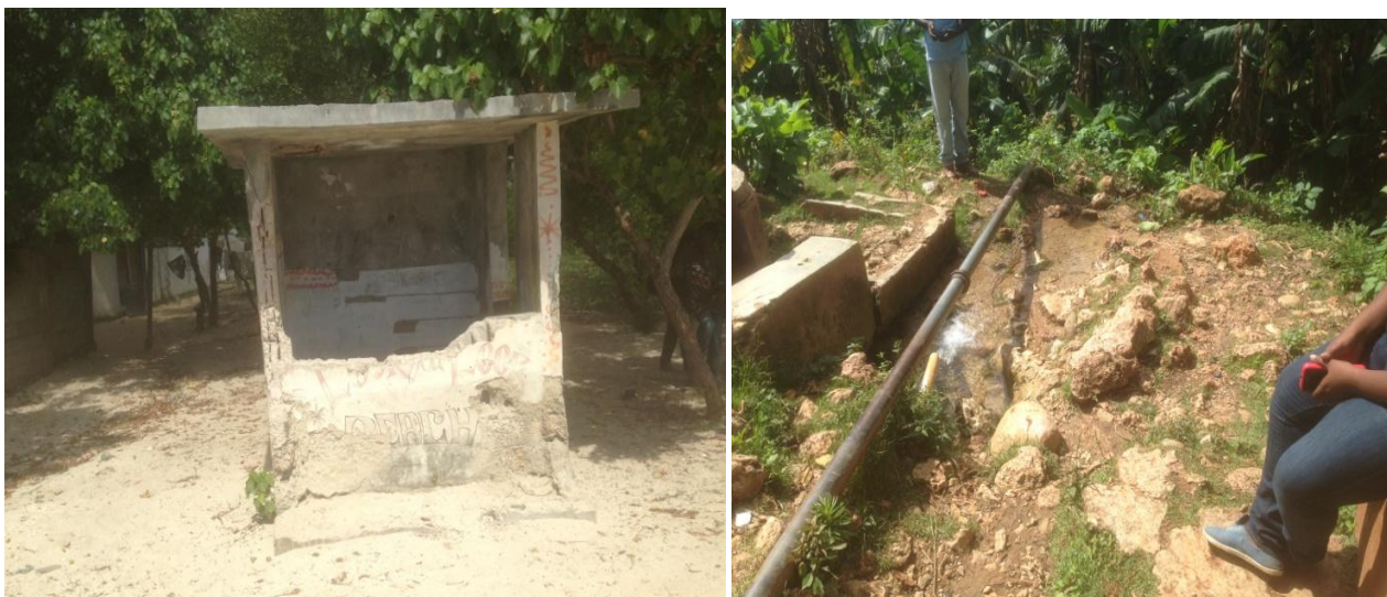
Kiosque et conduite sans protection
