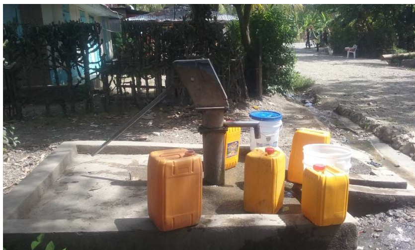
Figure 2-5 : Photographie de pompe à bras de Bas-Quartier
