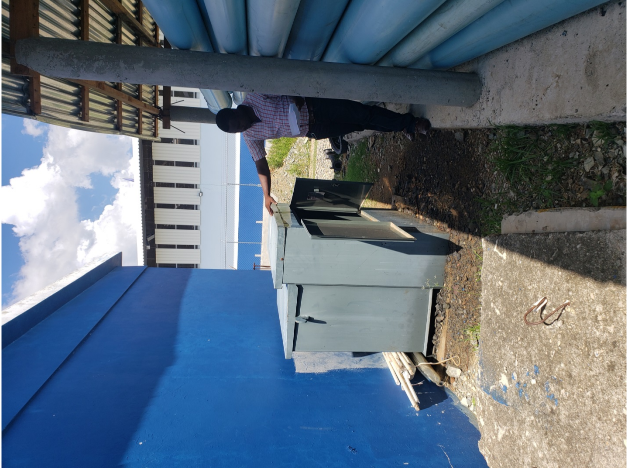
Transformateur triphasé 150 KVA
