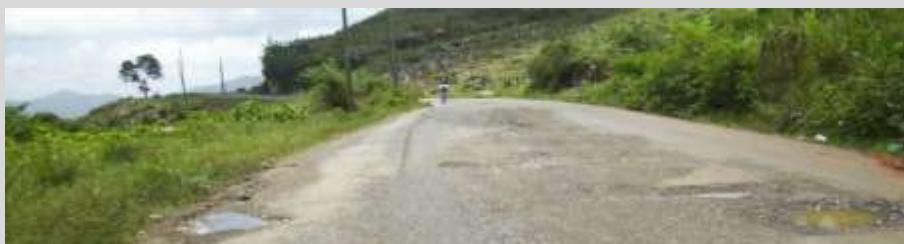
Photo présentant la dégradation accélérée de la chaussée de la Route Carrefour Puilboreau – Marmelade
