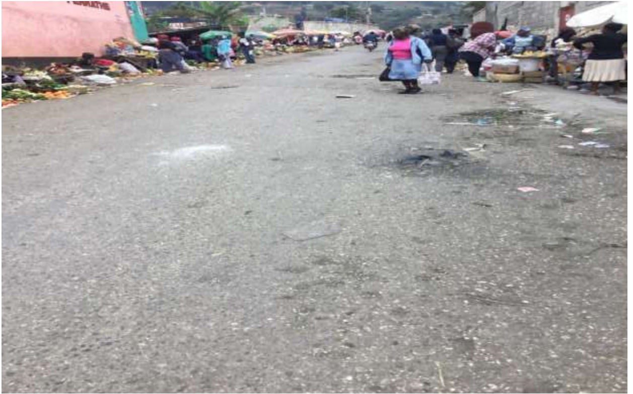
Chaussées dégradée ayant des cuvettes
