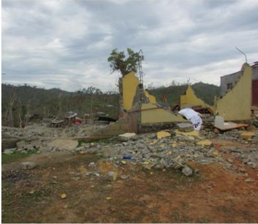
espace administrative de CATEPS completement detruit.
