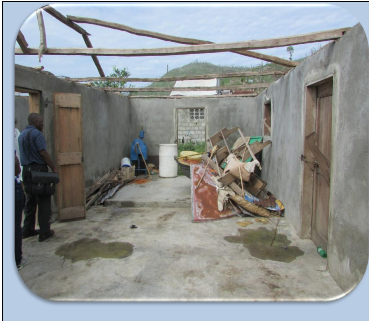
Photos 19. Les locaux de COPCOD au niveau de Chambellan avec son toit envolé lors du passage de Matthew. Le matériel administratif est perdu. Les archives sont irrécupérables. Le stockage de ceux qui restent n'est pas trop approprié.
