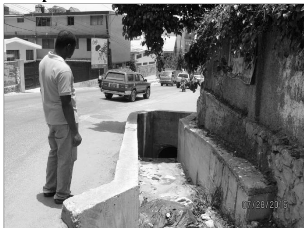
La tête du drain souterrain
