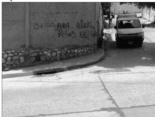
Rue Chavannes. Joints entre sections bétonnées
