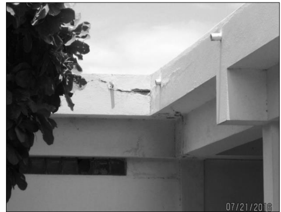
Dégradations notées sur un acrotère
