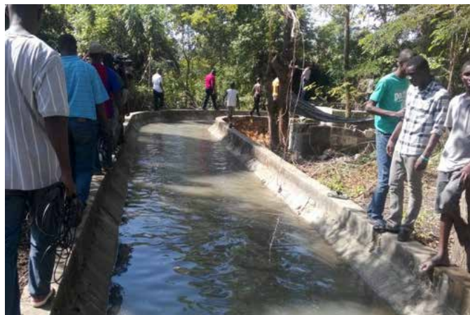
canal du système d'irrigation 2 ème section, Petit-Goâve
