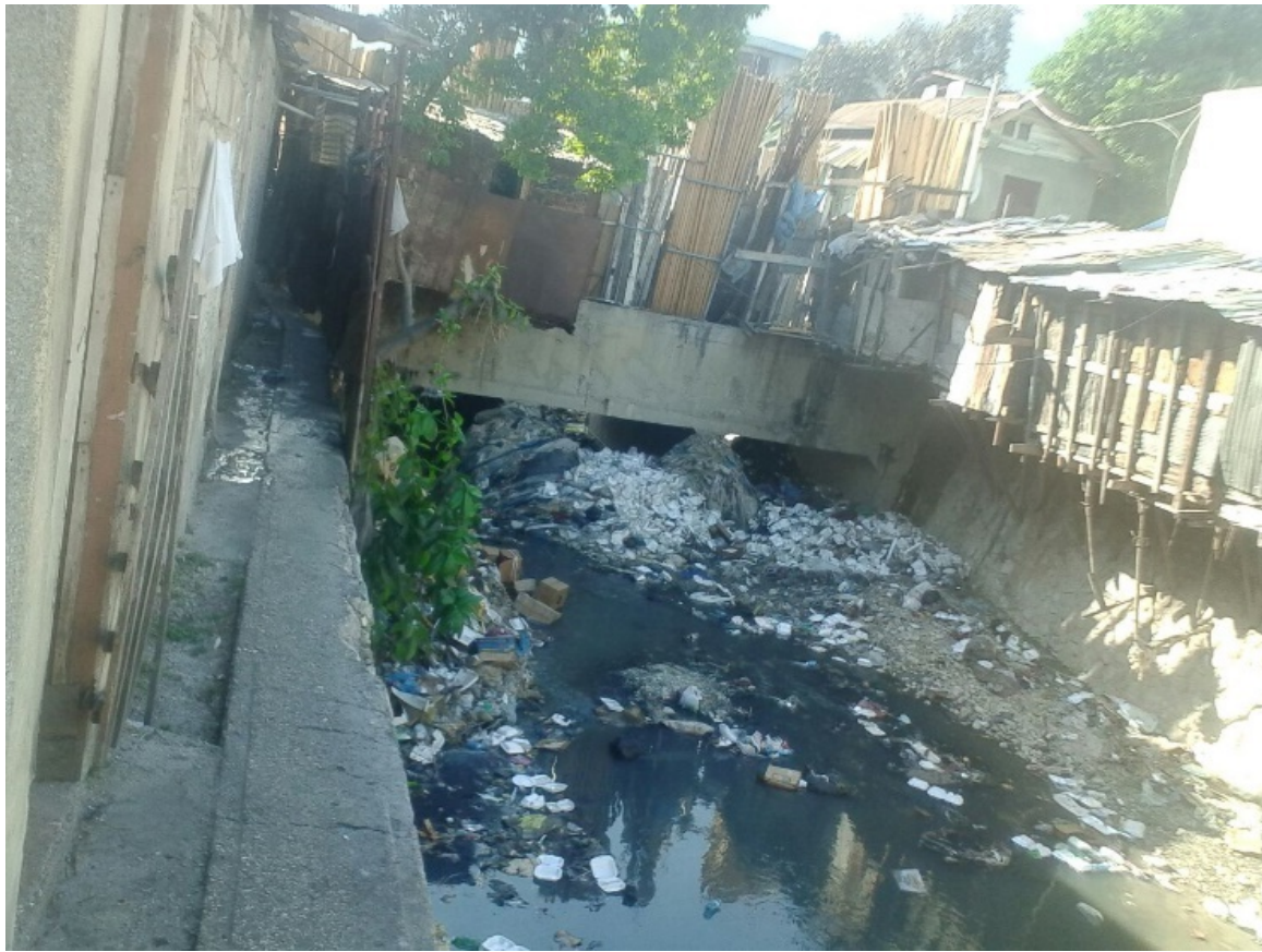
Franchissements (pont) occupé par usages commerciaux. Espace sur « pilotis » au-dessus du Bois-de-Chêne. La totalité de l'espace des 6 mètres du domaine est occupé d'un côté et de l'autre le mur d'un particulier est construit à moins d'un mètre du canal.
