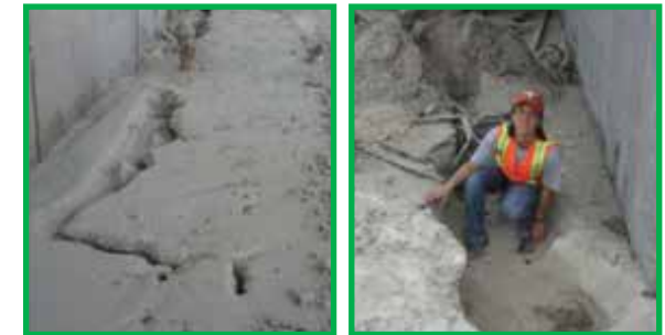
Ejections de l'eau et du sable à travers les fissures durant le secousse sismique
