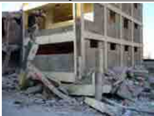
Fig. 13-11 Destruction du RdCh.
