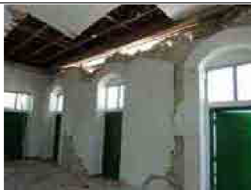
Fig. 5-10 Consultations générales, détail du 1 er étage très endommagé
