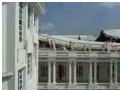
Fig. 2-7 Effondrement de l'étage par l'effet « coup-de-fouet »
