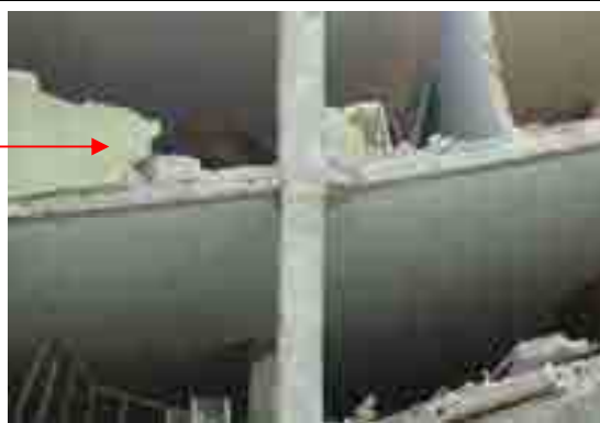
Fig. 6-8 Détail de la fig. 6-7 : absence des poutres
