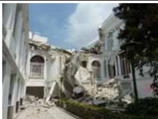
Fig. 2-3 Destruction des niveaux supérieurs
