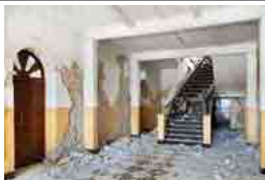
Fig. 7-26 Fissuration en X des murs
