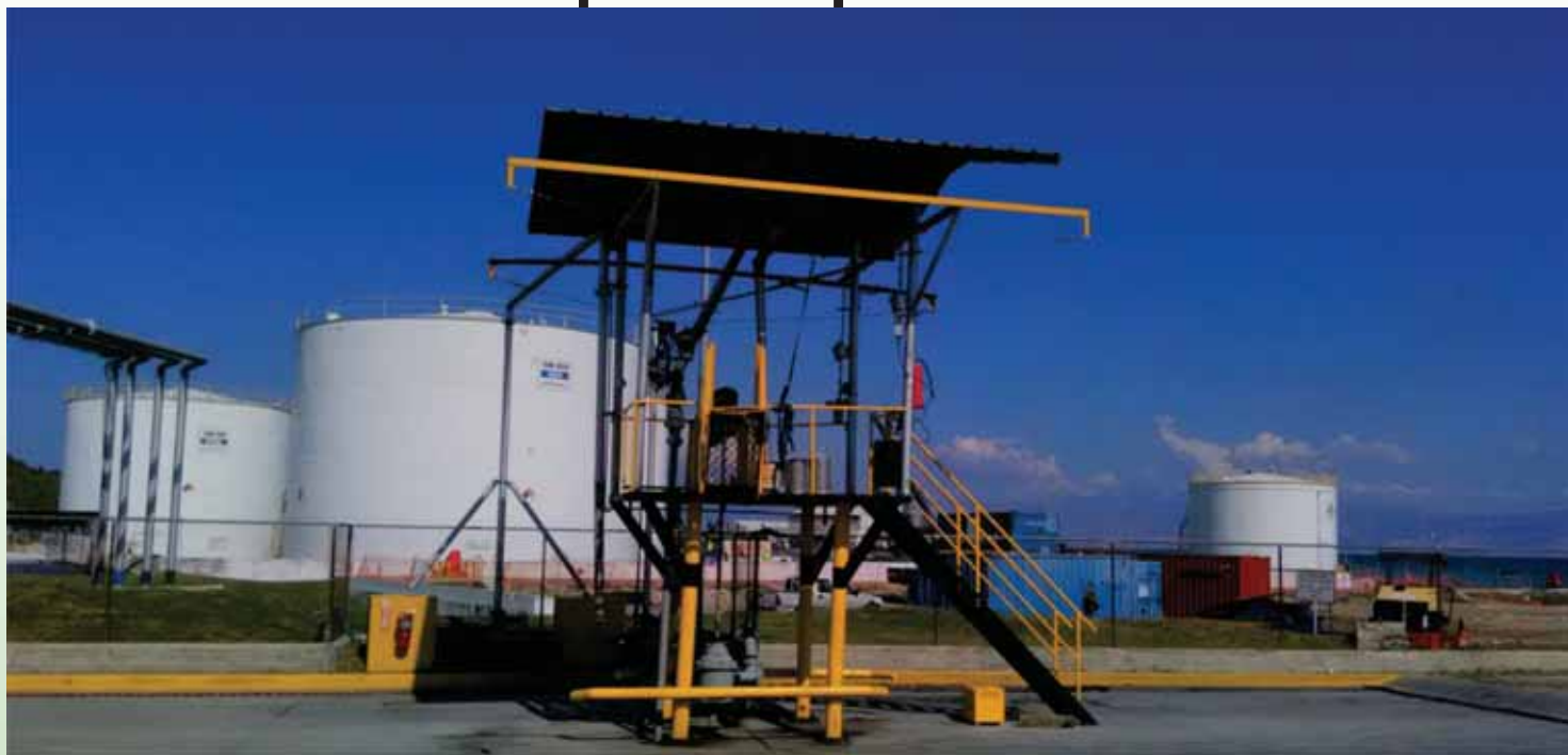
Vue d'un terminal de produits pétroliers
